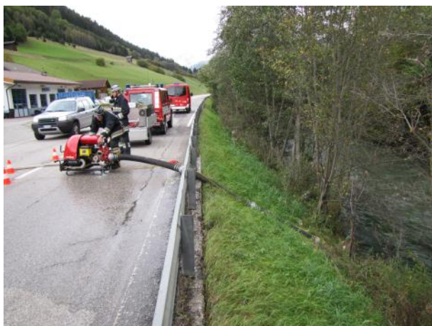
Die Saugstelle an der Rienz—Pumpe Welsberg
